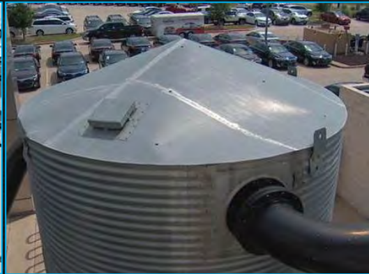
Air Conditioner Condensates
