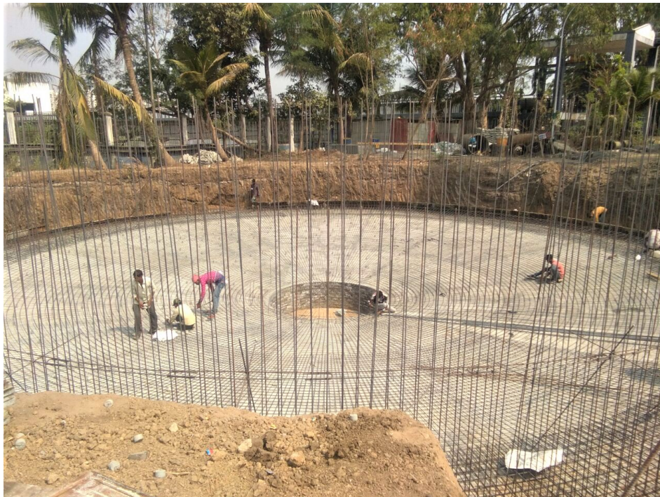
Filtrate Sump (ZLD)
